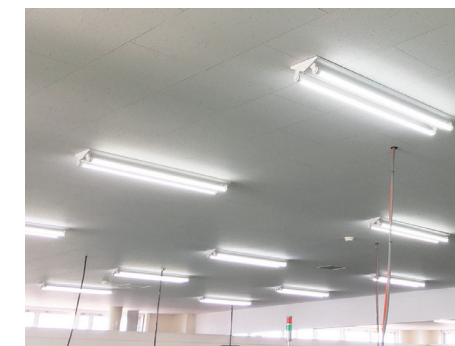
照明設備のLED化
